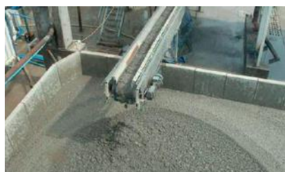
Descarga de sólidos después del procesamiento utilizando un Decanter Flottweg
